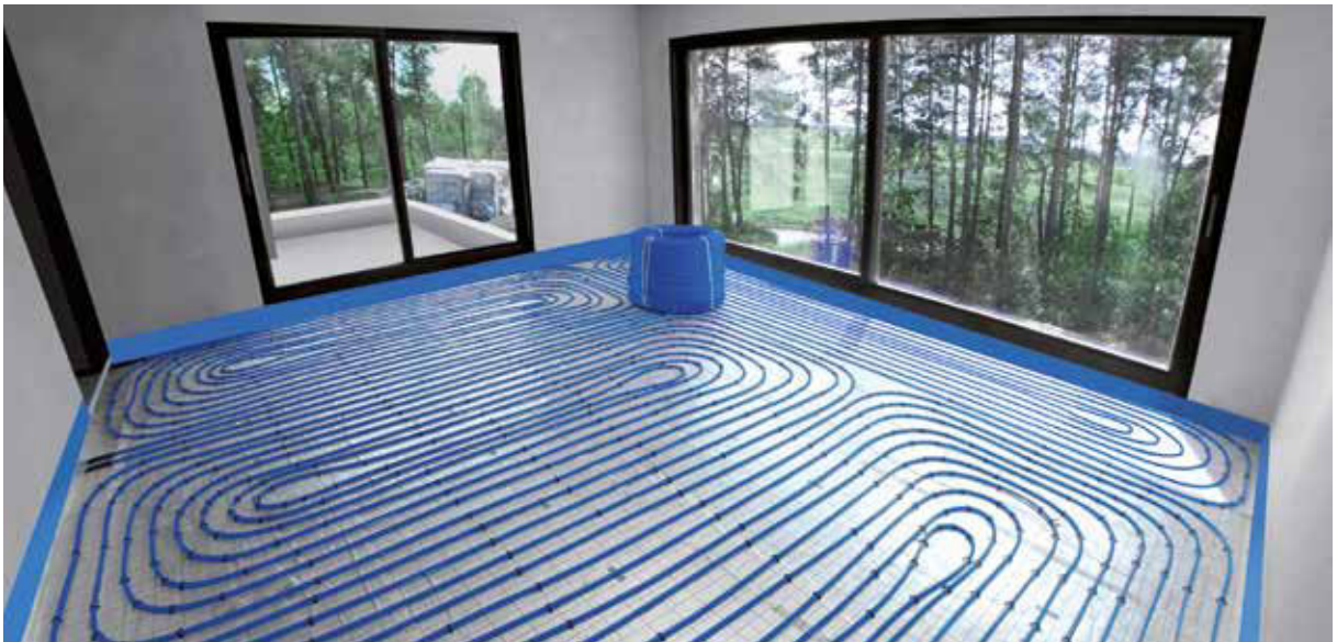
Slika 3. Instalacija podnog grijanja u jednoobiteljskoj zgradi, korištenjem bluePERT cijevi i KAN-therm Tacker sustava.
