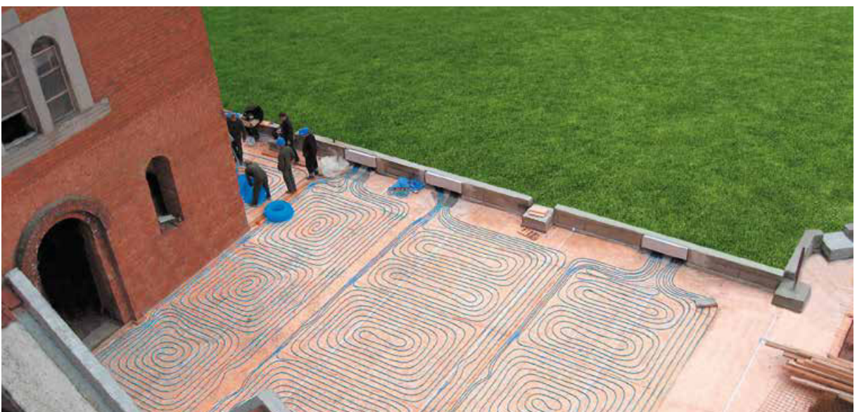
Slika 5. Instalacija grijanja vanjske terase korištenjem bluePERT cijevi KAN-therm sustava.
